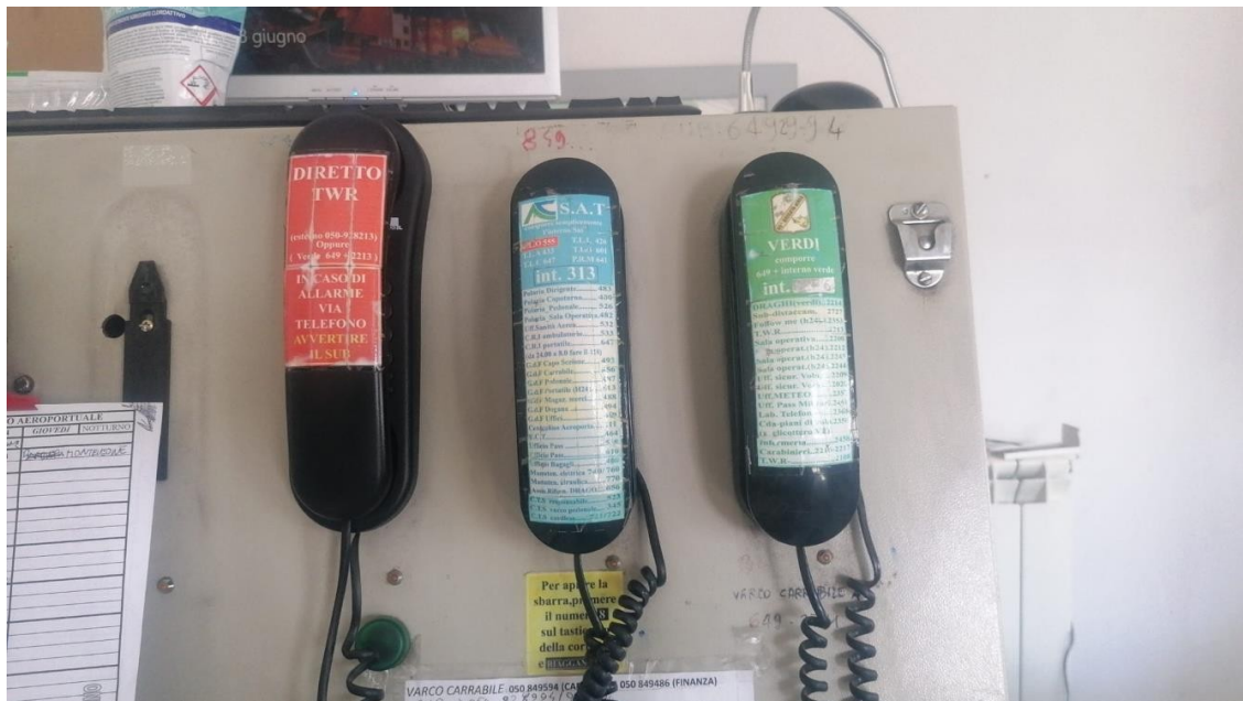
Linee telefoniche Centralino con luci LED di indicazione attivazione telefonica non funzionanti
